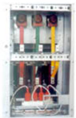
C 电缆室 Cable chamber
